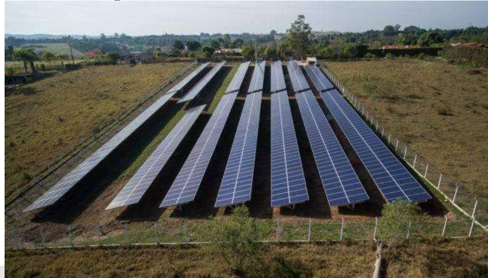
Figura 62: Placas fotovoltaicas instaladas em fazenda
