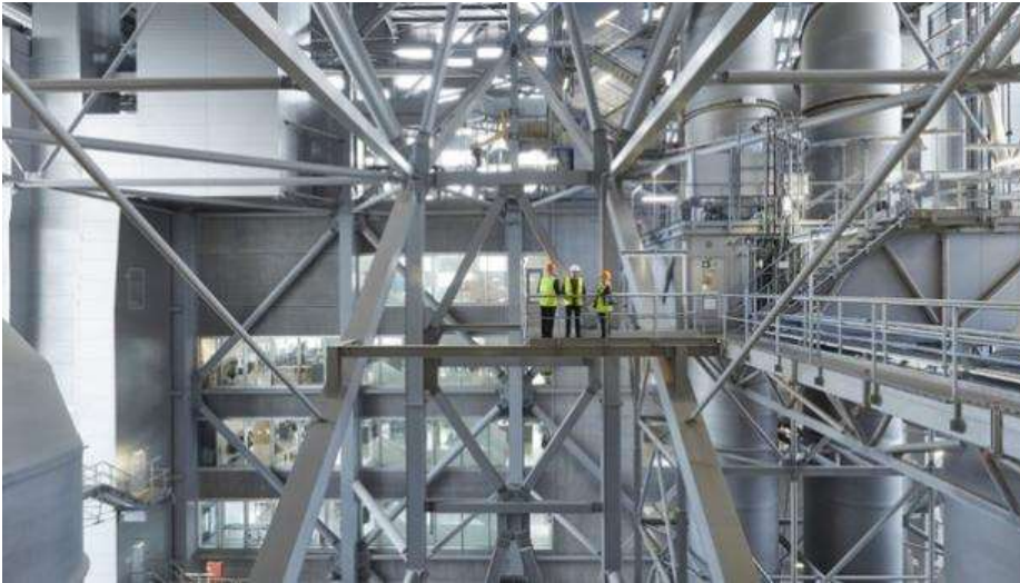
FIGURA 28: INTERIOR DA USINA - EQUIPAMENTOS.
