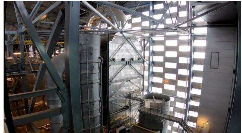
FIGURA 29: INTERIOR DA USINA – EQUIPAMENTOS.
