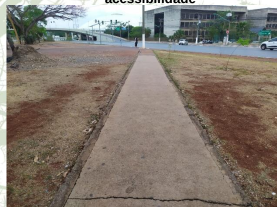
Figura 45: Calçada comprometida, sem acessibilidade
