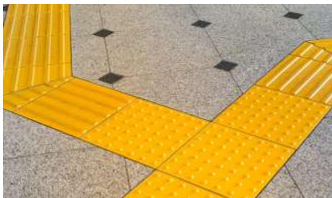
Figura 60: Imagem do piso tátil instalado. Fonte: https://whatplast.com (2021)
