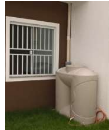
Figura 67 – Reservatório de Água pluvial
