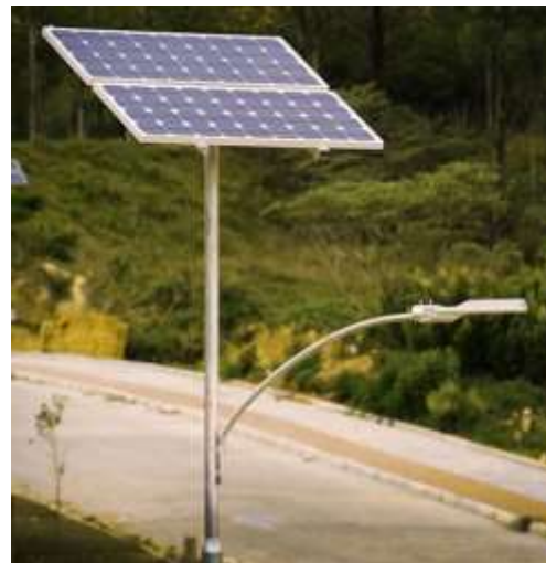
Figura 60 – Poste com Placas fotovoltaicas
