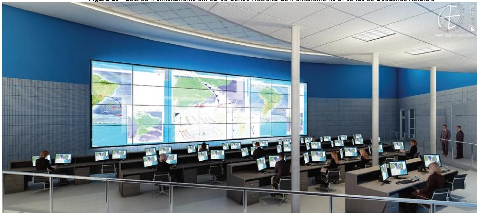
Figura 20 - Sala de Monitoramento em 3D do Centro Nacional de Monitoramento e Alertas de Desastres Naturais
