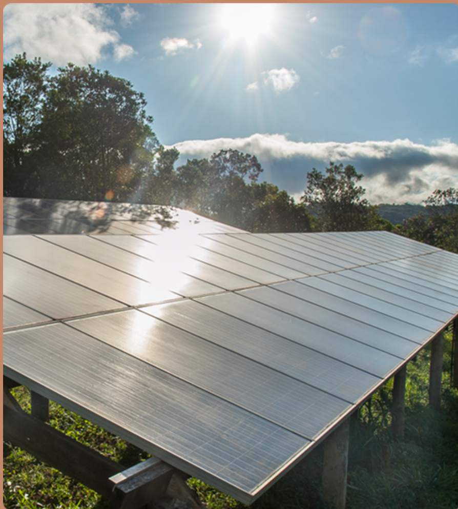
Figura 27: Instalações de Energia Solar.
