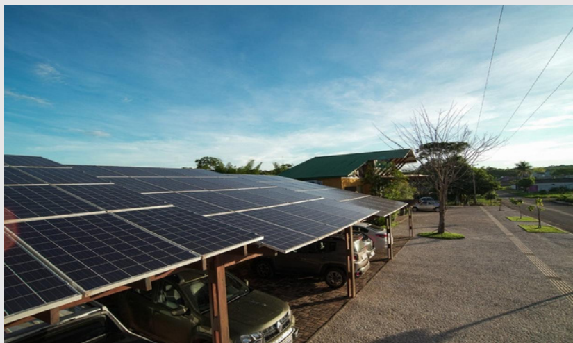
Figura 11: Placas solares Bonito Ectel
