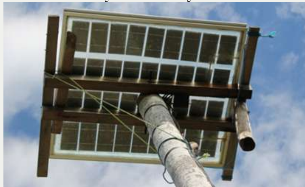
Figura 51: Sistema de energia solar
