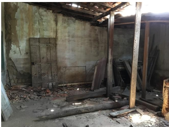
Figura 17: Cobertura do imóvel sendo apoiada com peças de madeira improvisadas. Fonte: Próprio Autor, 2017.
