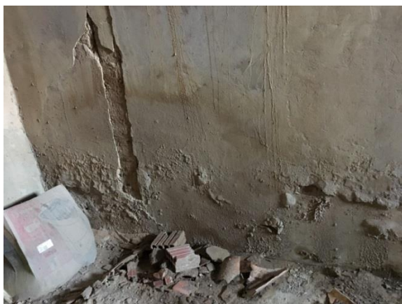
Figura 13: Eflorescência na parede. Fonte: Próprio Autor, 2017.
