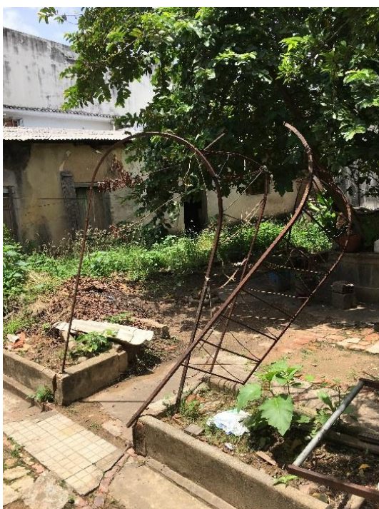
Figura 40: Pergolado metálico existente deteriorado.
