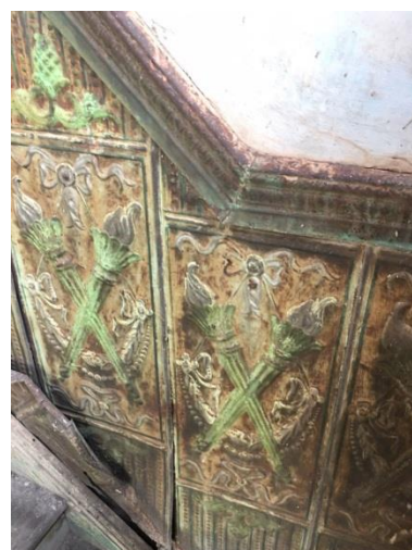
Figura 33: Escadaria do imóvel em péssimas condições.
