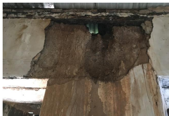
Figura 16: Lixiviação das paredes. Fonte: Próprio Autor, 2017.
