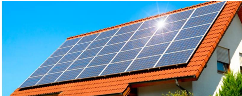
Figura 52 - Placas fotovoltaicas instaladas em telhado
