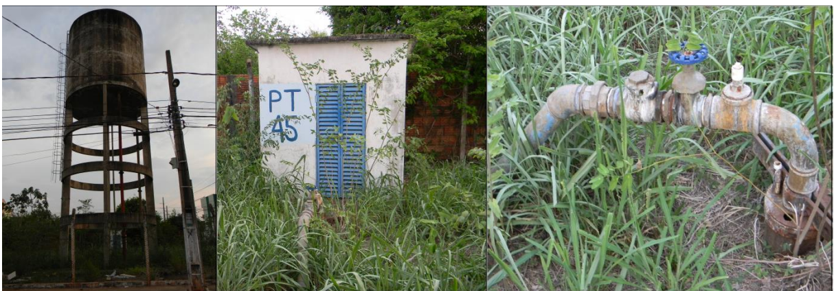
Figura 03: Poço de abastecimento de água do bairro Dom Orlando Chaves.
