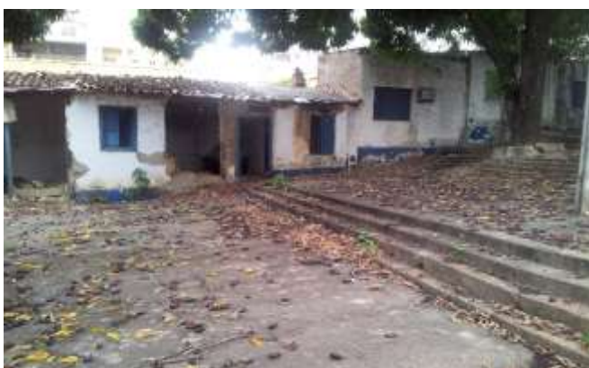
Figura 80 – Ruínas do anexo aos fundos do imóvel. Fonte: Arquivo IPHAN/MT, 2012.
