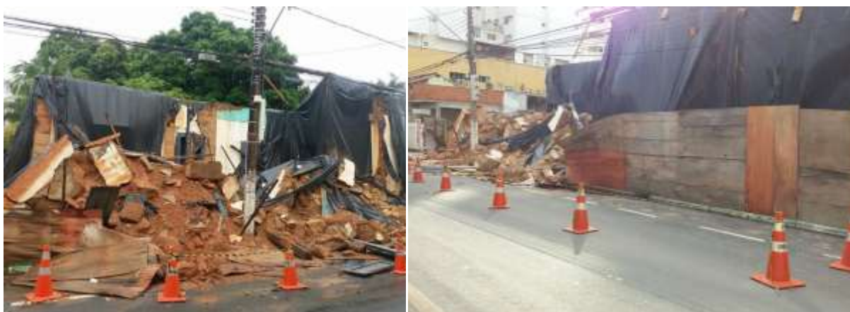
Figura 100 e 101 – Desmoronamento da Casa de Bem Bem.
