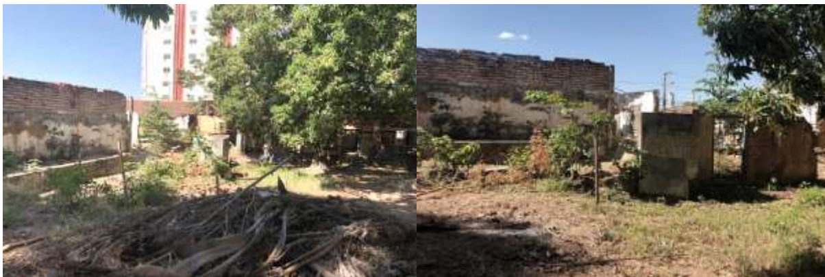
Figura 122 e 123 – Local da nascente ainda com as paredes em pé. Fonte: Adaptado de RENOVA Engenharia e Consultoria, 2019.
