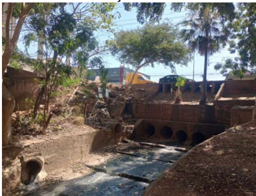
Figura 4.18 - Córrego do Gambá, recebendo esgoto das residências e comércios do seu entorno – Av. Fernando Correa da Costa, 216 - Poção – Cuiabá
