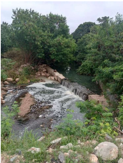
Figura 4.42 - Entorno do córrego com grande volume de detritos e entulhos das obras inacabada do córrego – Rua 8 de Maio, 208 - Pedregal – Cuiabá
