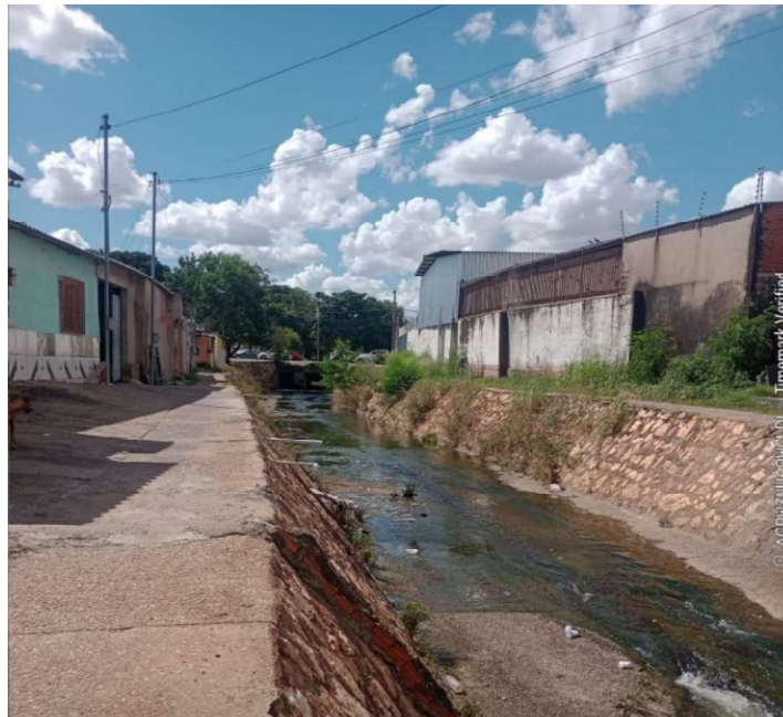
Figura 5.6 - Córrego do Gambá, recebendo esgotos e resíduos sólidos das residências do entorno – Av. Manoel José de Arruda, 225 - São Mateus – Cuiabá
